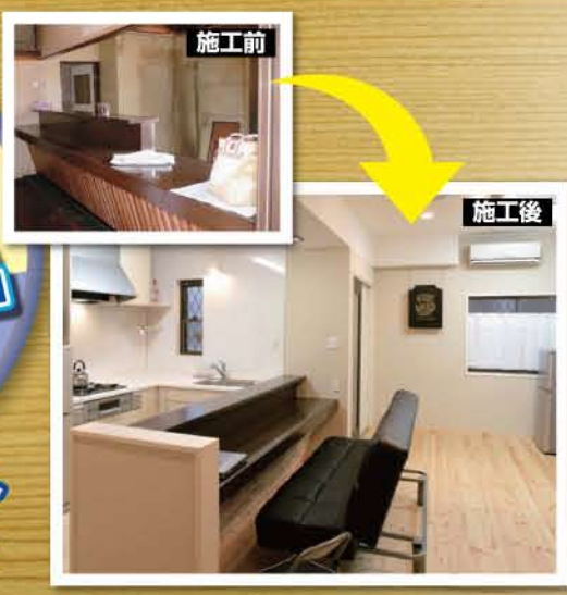
以前は店舗だったスペースを快適なLDKへ。 内装は無垢のバイン材や珪藻土を使用し、 自然素材を使った、温かみのある空間にしました。
